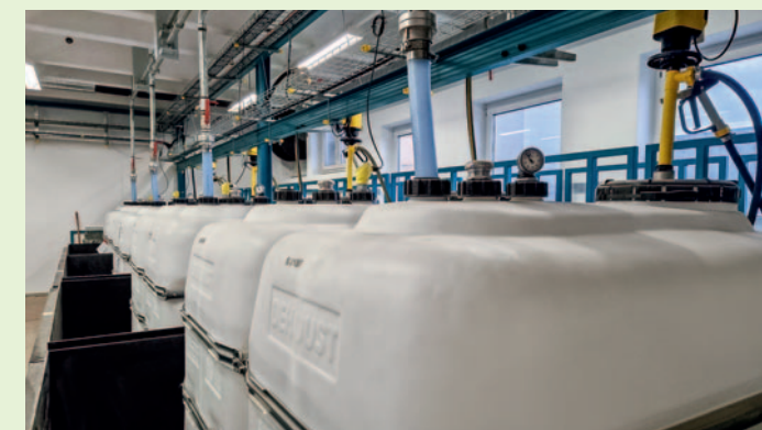
Die Mischung macht's: die neue Farb- und Zusatzmitteldosieranlage im Betrieb
