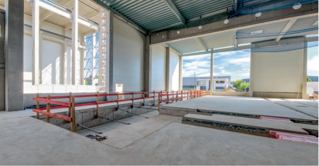
Die neue Fertigungshalle setzt auf ein robustes Skelettsystem mit Stahlbetonbodenplatten
